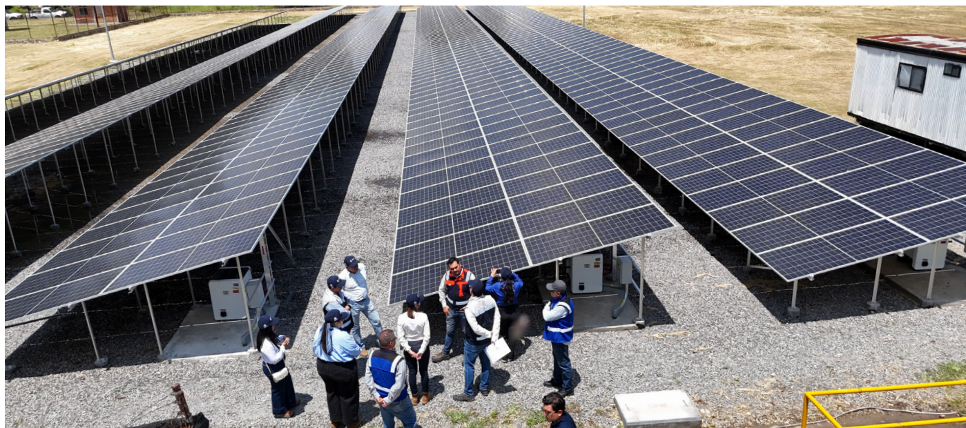
Vista Aérea, Sistema Fotovoltaico
